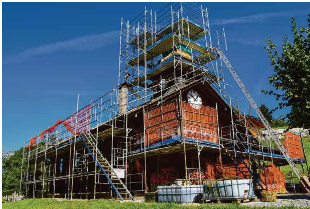
En plus de la rénovation de sa toiture, la chapelle de la Forclaz devra être mise aux normes anti-feu.
